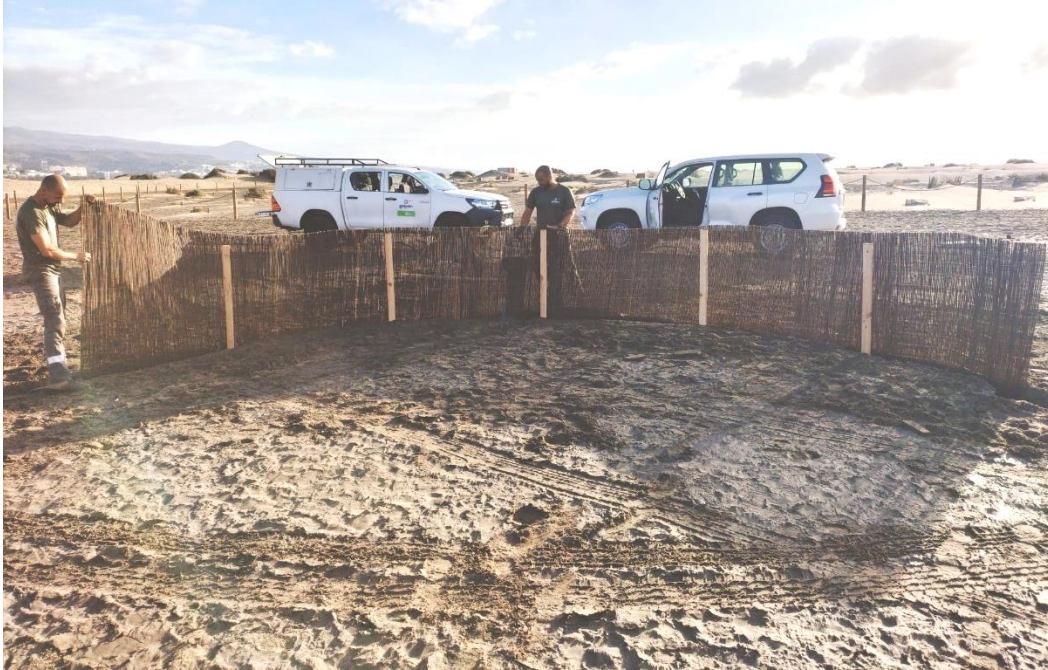
Imagen nº 9: Colocación del mimbre dentro de la zanja con extremo cuidado. Fuente: Gesplan S.A.
